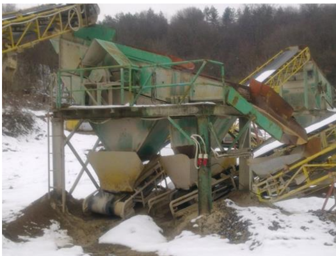
Postrojenje za drobljenje kamena
